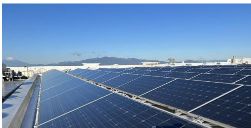
荏原製作所藤沢事業所 太陽光発電設備
