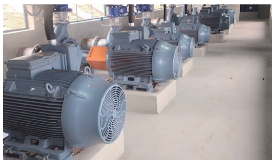
灌漑給水に使用されている高効率ポンプGS型
