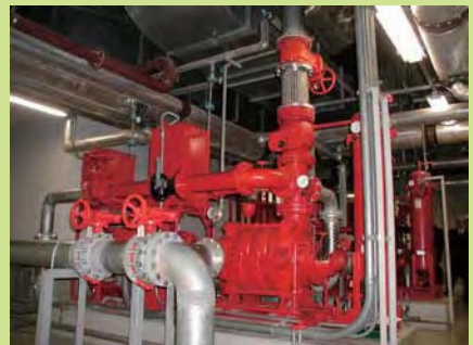
消火ポンプユニット
